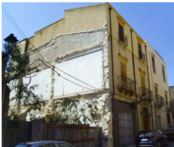
unità edilizie 7 "edifici allo stato di rudere"
