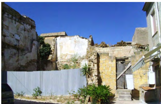
unità edilizie 15 - 16 "edifici allo stato di rudere"
