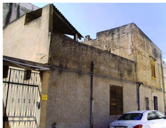
unità edilizie 18 - 19 "edifici allo stato di rudere" 20
