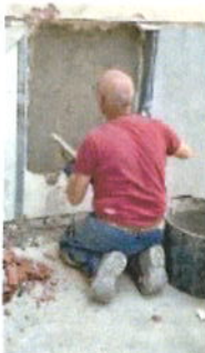
Una parete sfondata per entrare nel negozio e disattivare l'impianto di antifurto
