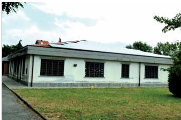
Pannelli fotovoltaici sull'asilo di via Terracini
