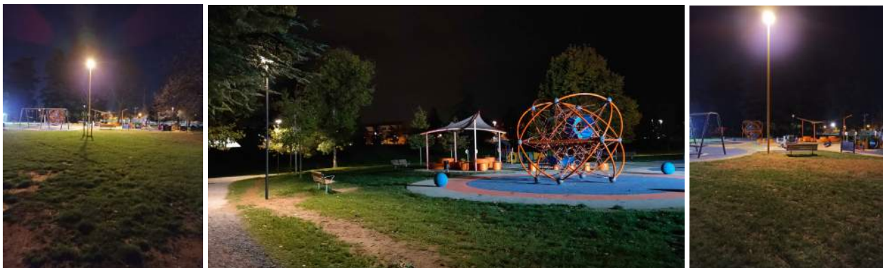
Particolare nuovo impianto illuminazione
