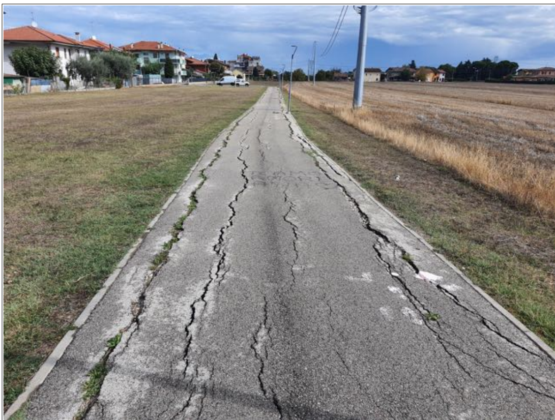
Figura 8: Lesioni sulla “ciclo-pedonale” al confine nord occidentale del lotto legata ai fenomeni di ritiro-rigonfiamento dei terreni argillosi.
